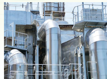
設備機器、プラント、電力室
