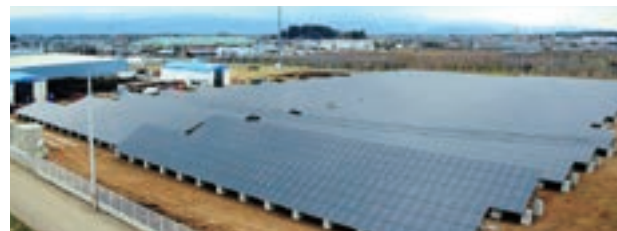
山形事業所 2013年設置 システム容量732kW
